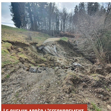
LE CHEMIN APRÈS L'EFFONDREMENT
