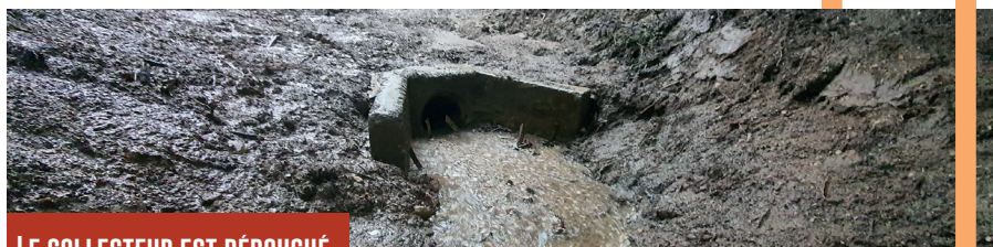
LE COLLECTEUR EST DÉBOUCHÉ
